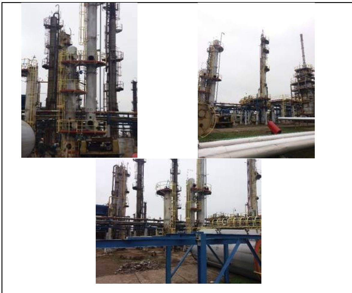
Слика 3. Постројење 07 „Рекулпација гаса - LPG“
