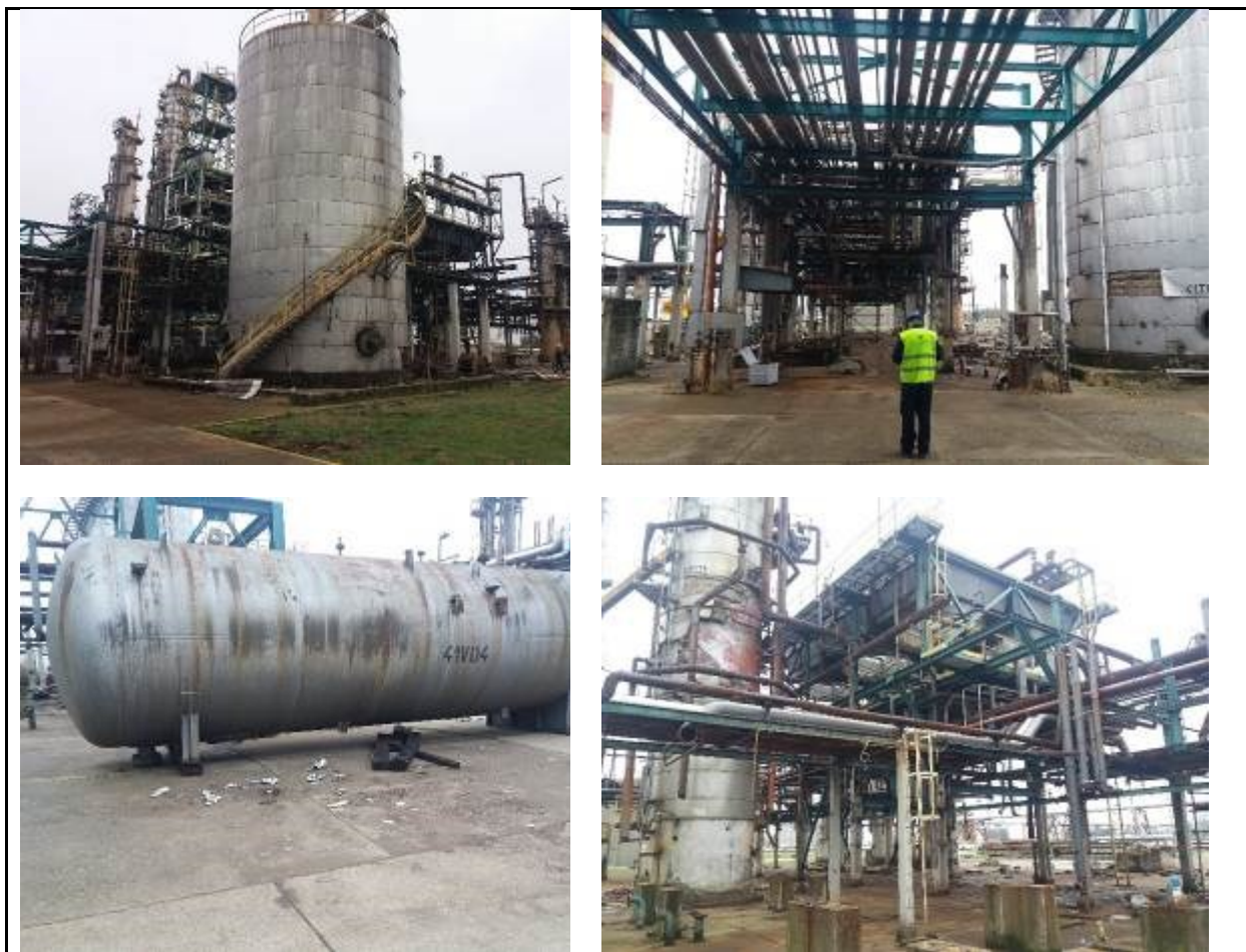
Слика 7. Део постројења 41 „Propan deasfалting“
