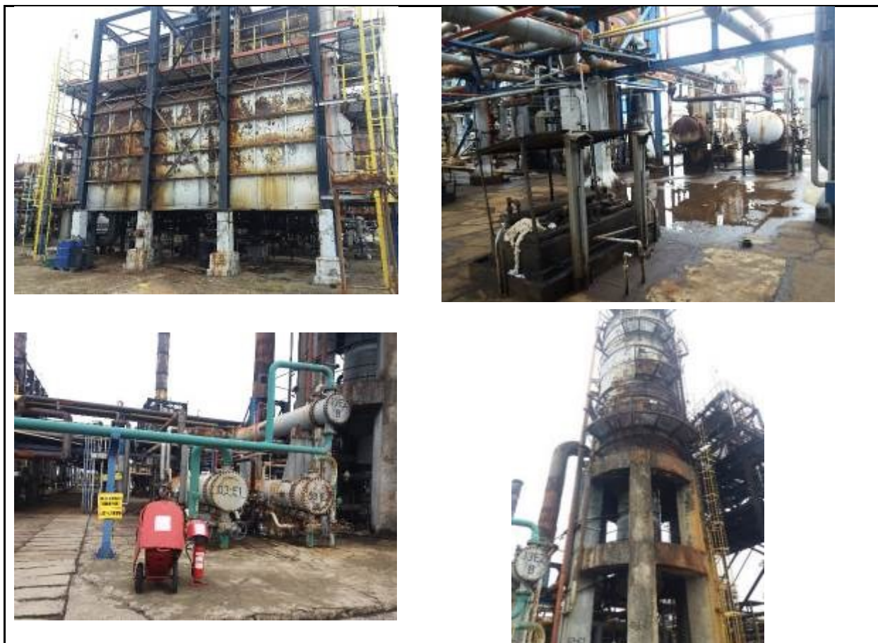
Слика 2. Постројење 03 „Вакум дестилација“
